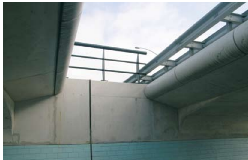
Daglichttoetreding door niet overkappen van middenberm.
