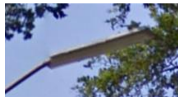
Figuur 2 Huidig TL-armatuur
