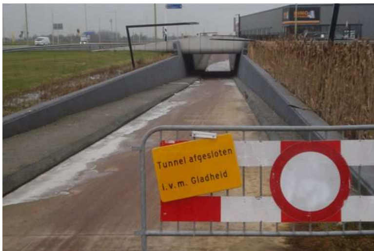
Bevroren lekwater in fietstunnel onder Oudelandselaan (foto Gerard Bovens)
