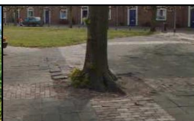
Verharding oogt slecht en heeft schade.
